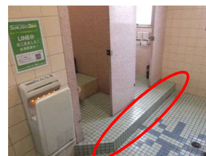
④トイレ個室入口段差
