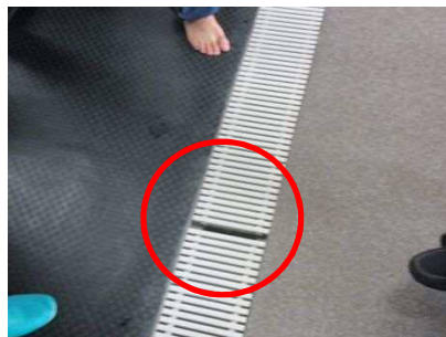
①会場内通路側溝隙間
